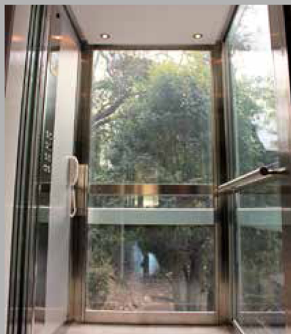
porte di cabina a soffietto
